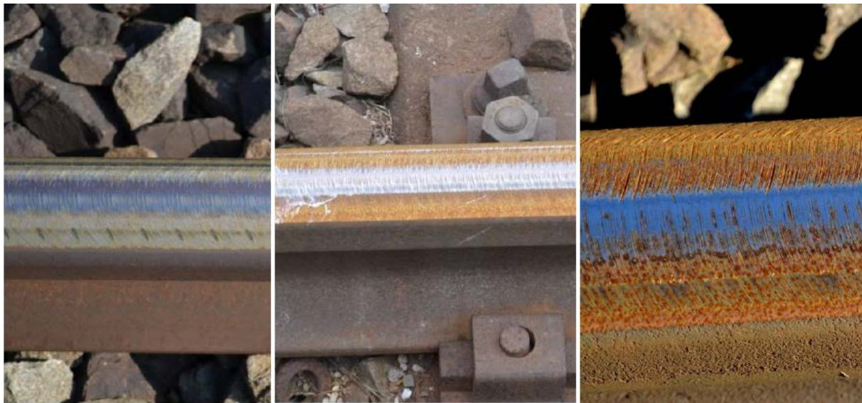
Abbildung 58: Schienenoberfläche direkt nach Schienenbearbeitung mit rotatorischem Verfahren (links), mit zeitlichem Abstand zur Schienenbearbeitung (mittig) und nach 19 Monaten Betrieb der Strecke (rechts) (Charakteristik: Nahverkehr mit Fahrzeugen mit niedrigen Achslasten) [2]
