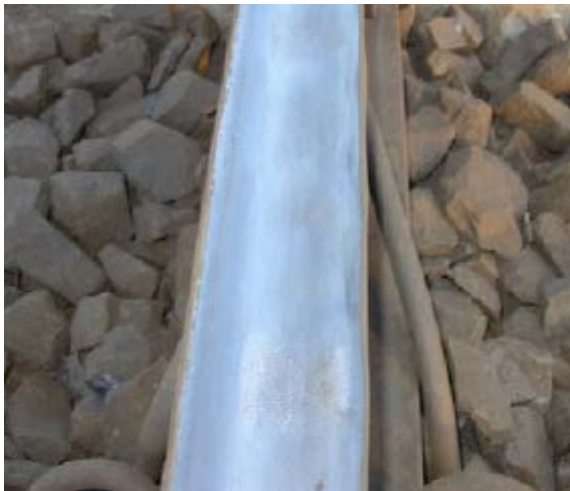
Abbildung 14: Oberfläche einer Eisenbahnschiene mit Schlupfwellen [13]
