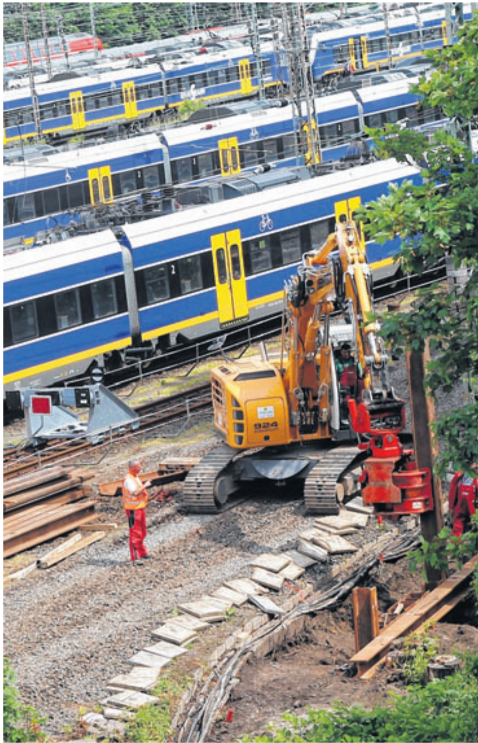
Um Kabel unter den Gleisen verlegen zu können, werden meterlange Stahlträger senkrecht in den Boden gerammt. FOTO: FRANK KOCH
