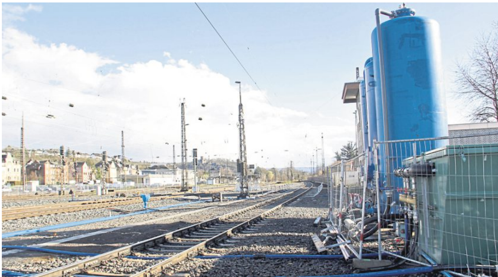
Mit Förderbrunnen wie diesen versucht die Bahn seit Monaten, den verbliebenen Dieselkraftstoff aus dem Boden zu bekommen.
