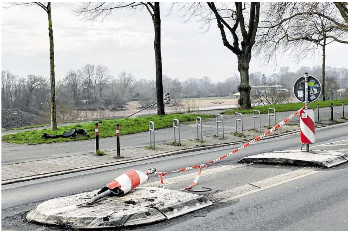
Etwa einmal im Jahr, schätzt das Amt für Straßen und Verkehr, werde eine der Mittelinseln auf dem Osterdeich bei Unfällen beschädigt – hier Ende Februar in Höhe der Berliner Straße.
